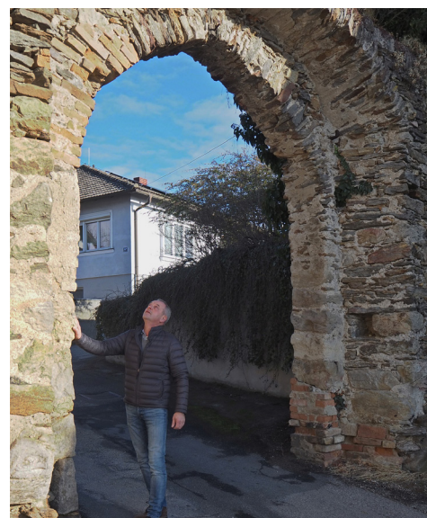
Andreas Schuster begutachtet die Schäden beim Biritor
